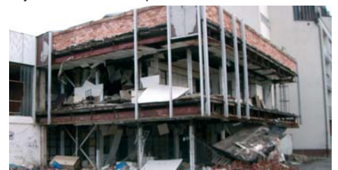
Zrúcanina: Budova Satelitu sa rekonštrukcie tak skoro nedočká
